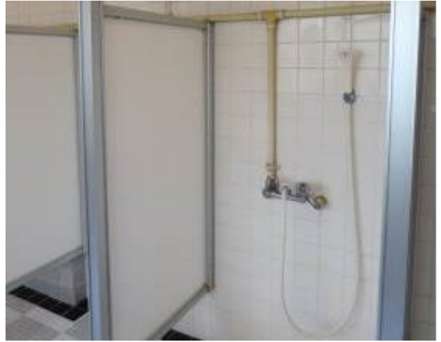
< 浴室内シャワー Shower in public bath >
