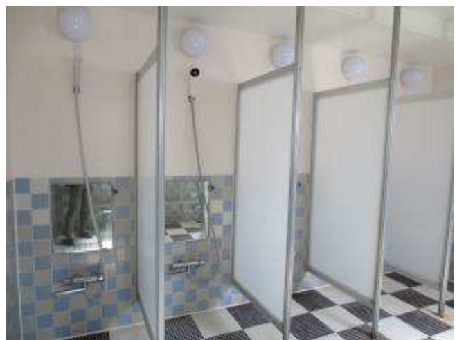
< 浴場内シャワー Shower in the bathroom >
