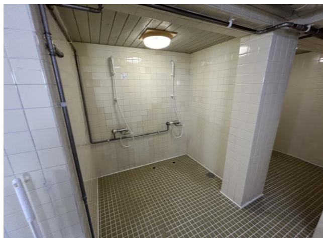
< 浴室内シャワー Shower in public bath >
