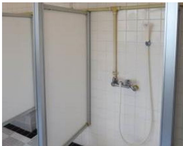
< 浴室内シャワー Shower in public bath >
